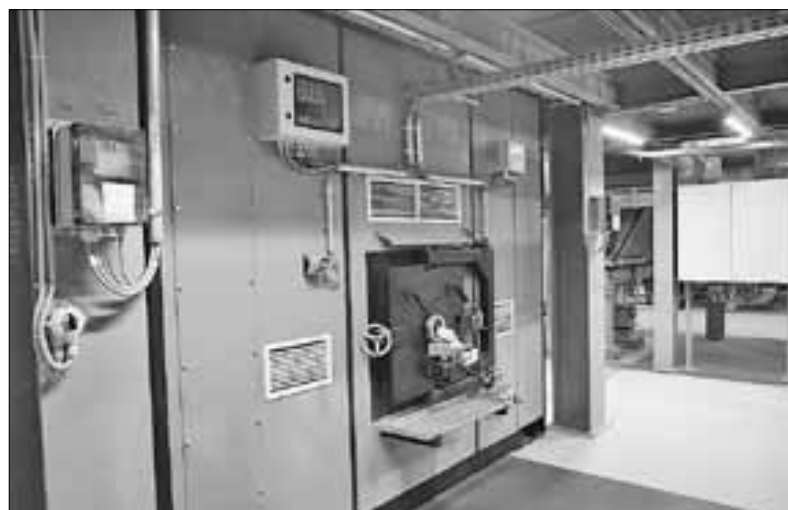
■ Современная котельная работает на отходах производства
